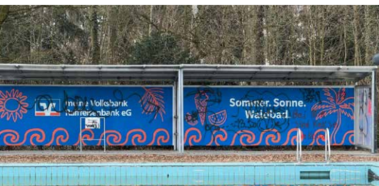
Über den Winter wurden mehrere Wände sinnlos beschmiert.
