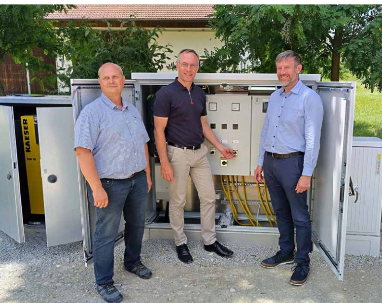
Foto (v.l.): Christian Erdösi, Abteilung Abwasser, 1. Bürgermeister Robert Pöttsch, Herbert Lechner, Geschäftsführer Stadtwerke beim Steuerschrank in Ebing
