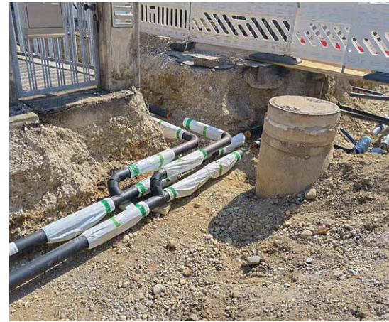
Verrohrung für einen Hausanschluss in der Birkenstraße
